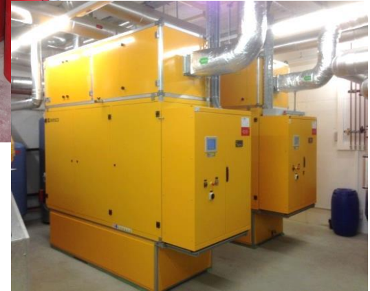
BHKW in der Nahwärmezentrale Birnbäumen
