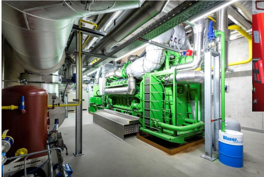
Gross-BHKW in der Fernwärmezentrale Au
