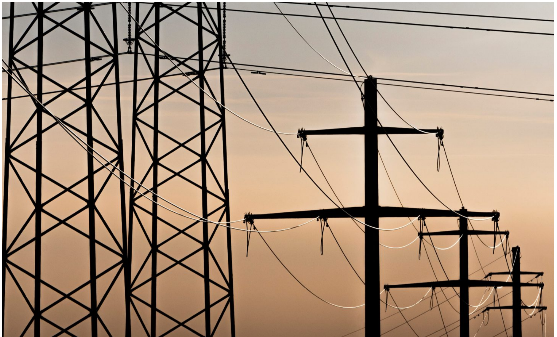
Die Energiebranche ist nach dem Aus des Stromabkommens verunsichert: Starkstromleitungen in der Nähe des Umspannwerks Brütten. Foto: Urs Jaudas
