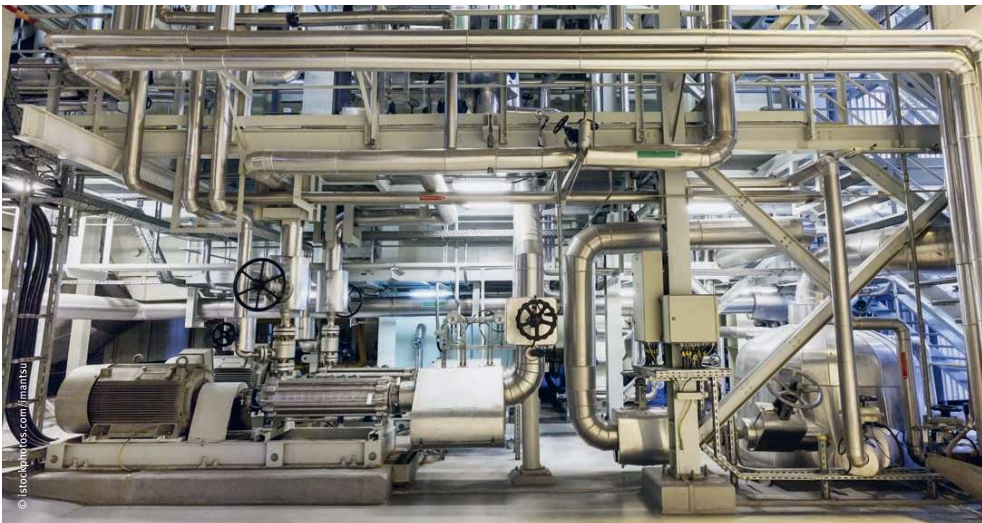
Centrale de cogénération moderne de moyenne puissance
