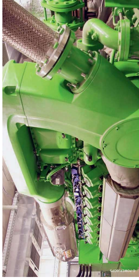
16 Zylinder Gasmotor der Wärmezentrale von Charmey
