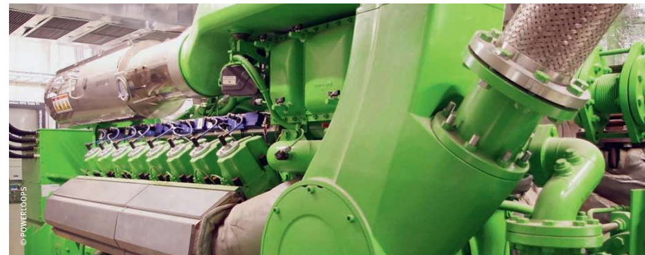
Moteur à gaz 16 cylindres de la centrale thermique de Charmey
